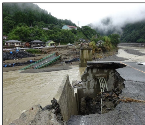
流失した国道 219 号の鎌瀬橋 （令和 2 年 7 月 19 日（日）16 時 38 分）
