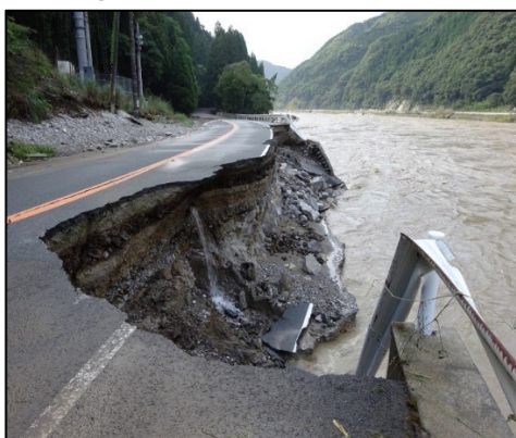
路肩が崩壊した国道 219 号 （令和 2 年 7 月 4 日（土）16 時 49 分）
