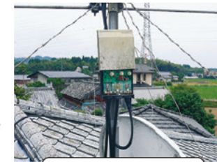
経年劣化したブースター
