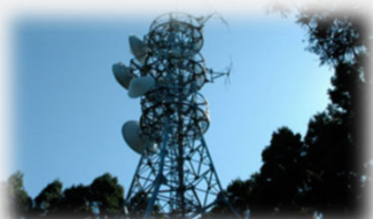
防災行政無線設備の被災
