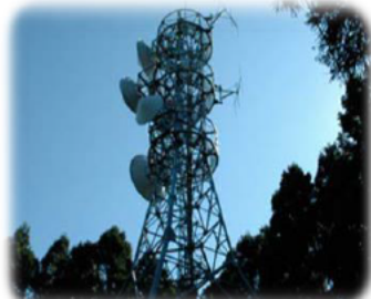
被災した防災行政無線 設備の代替
