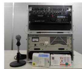
臨時災害放送局用 FM放送設備 1台
