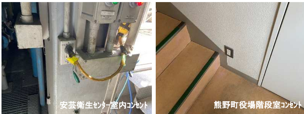
図 4-14 実験局の電源取り口
