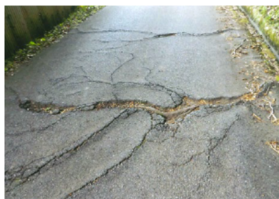
▲木の根が浮き上がり、道が凸凹。 自転車で通る際に危険！
