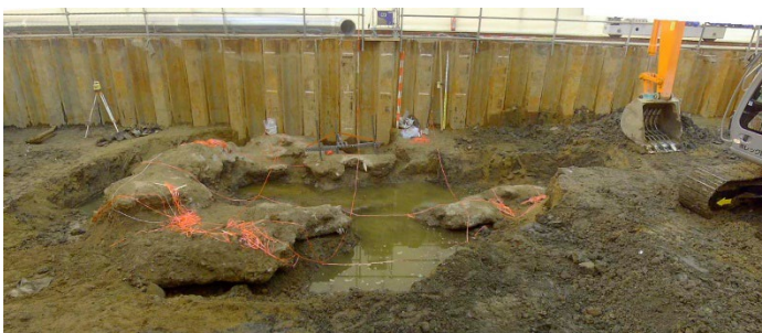
(写真) 汚染源掘削調査により発見された コンクリート様の塊（平成 17 年 1 月 27 日撮影）
