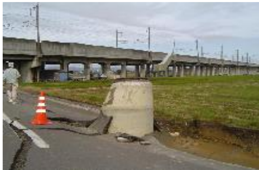
液状化で浮上したマンホール（約1,300箇所）
