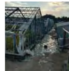
被災したガラスハウス (令和元年房総半島台風)
