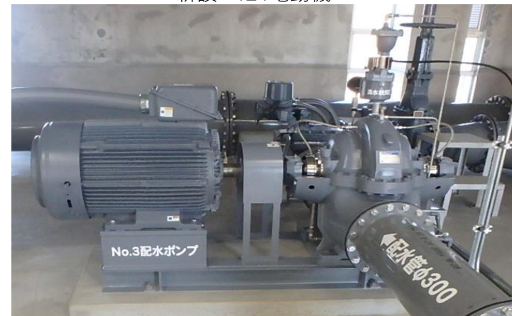
新設 IE4電動機
