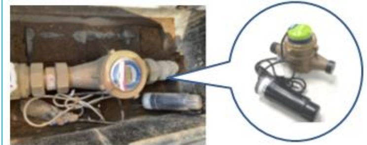
東京2020大会選手村（東京都中央区晴海）に設置しているスマートメーター
