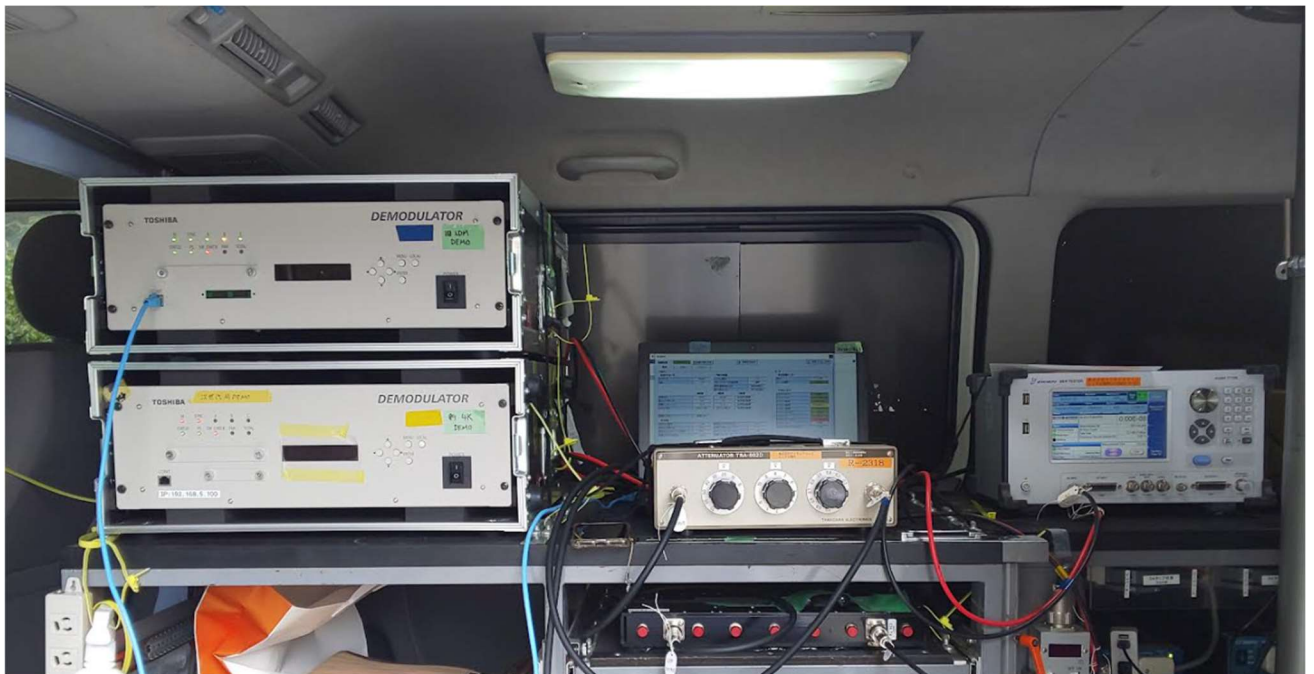
図 4.3-1 測定車内に設置した機器類
