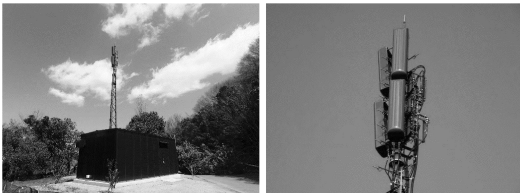
図 1-1 生駒実験試験局の全景と送信アンテナ外観
