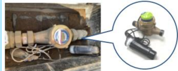
東京2020大会選手村（東京都中央区晴海）に設置しているスマートメーター
