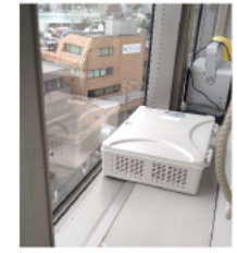
←局内の設置 (総務部内のキャビネットの上に設置)
