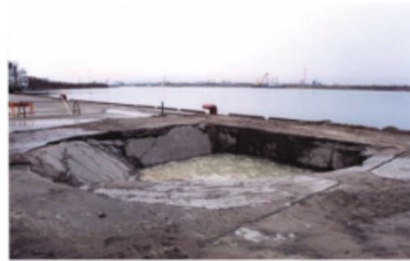
陥没した港湾施設のエプロン部分
