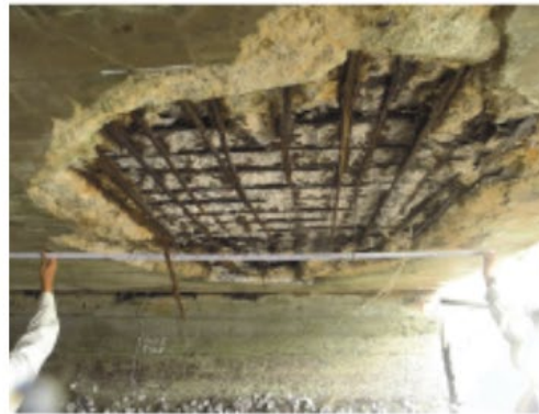
内部の鉄筋が露出した橋梁
