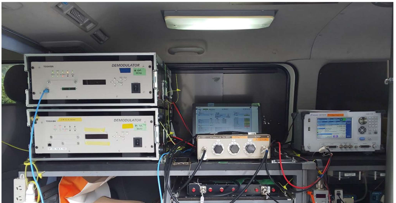
図 4.3-1 測定車内に設置した機器類
