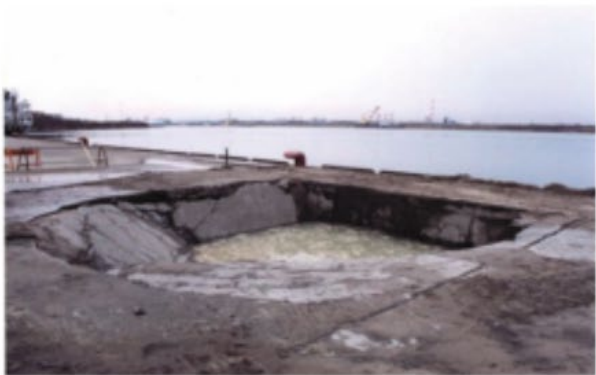
陥没した港湾施設のエプロン部分
