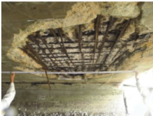
内部の鉄筋が露出した橋梁
