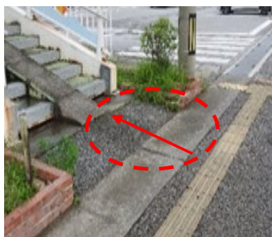
誘導用ブロックが未設置 (国道 58 号)
