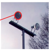
水銀灯の老朽化により、設備が故障し、受信障害を与えています。
