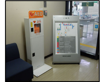
庁舎内のAED設置例（熊本地方方法務局）
