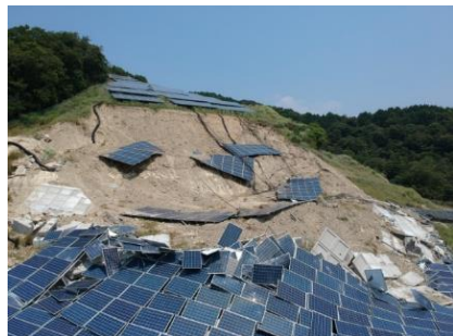
土砂崩れで生じた崩落
