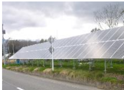
柵塀の設置されない設備
