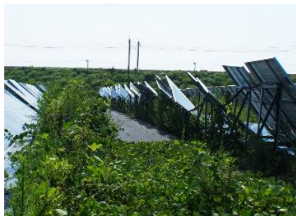
不十分な管理で放置されたパネル
