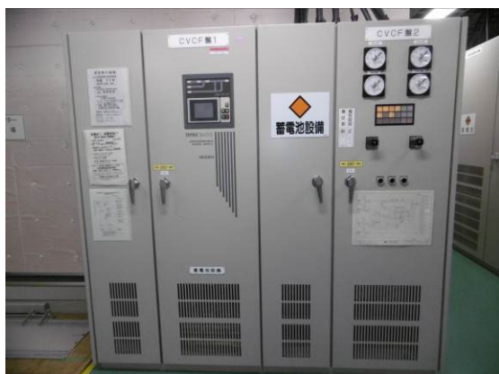
無停電電源装置設備
