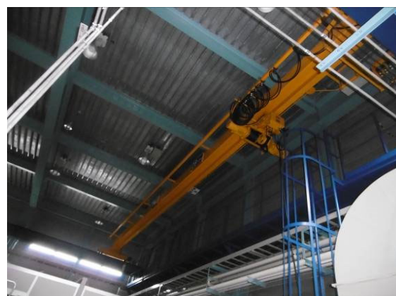
ホイスト式天井クレーン設備
