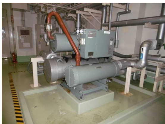
冷水・冷却水設備
