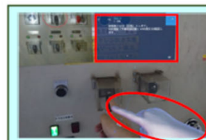
HMDを通して見た設備の操作盤。現実世界（設備）にデジタルコンテンツ（ここでは、作業マニュアル【上の四角枠】と同マニュアルに基づく操作対象を指差す3DCGの手【下の丸枠】）を重ねて表示している。
