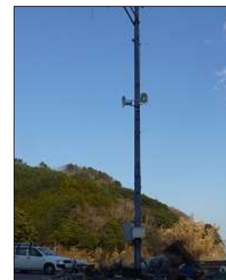
既設子局柱（浸水被害）を利用
