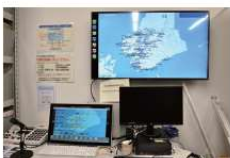
▲市内のスピーカーや戸別受信機への放送を行う防災行政無線システムの操作卓。中継局や拡声子局等、市内130以上ある関連設備の遠隔監視も可能
