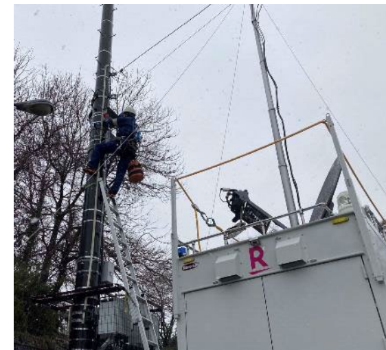
震災で破損した 基地局の復旧支援体制
