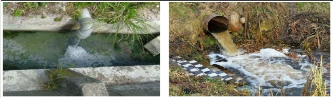
図3 単独槽から生活雑排水が未処理のまま水路に流入している例
