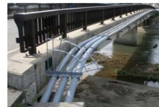
橋梁添架管路
