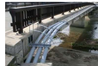
橋梁添架管路
