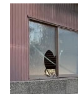
窓が割れた管理不全空家
