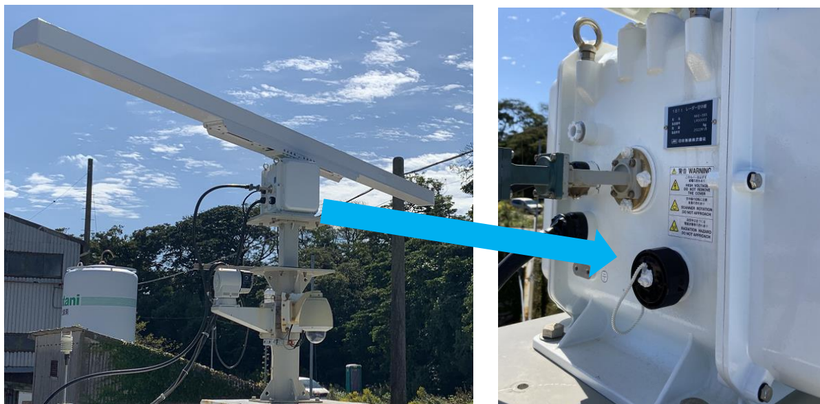
図 3-31 試作アンテナ設置後の様子
