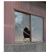
窓が割れた管理不全空家
