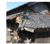
緊急代執行を要する崩落しかけた屋根
