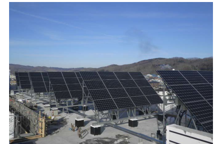
同時導入された太陽光発電設備
