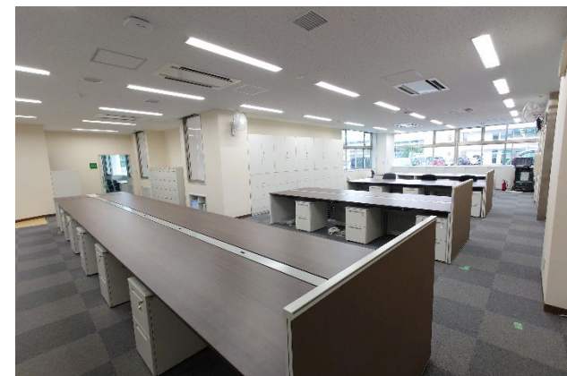
LED照明の導入
