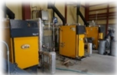
バイオマスボイラー
