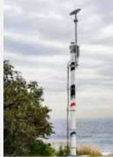
衛星回線を活用した基地局
