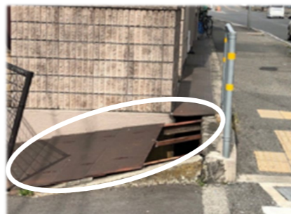
【Before】水路の溝蓋が外れ柵が一部にしかなく、児童生徒が転落するおそれあり
