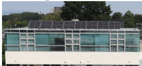
再生可能エネルギー（太陽光）設備
