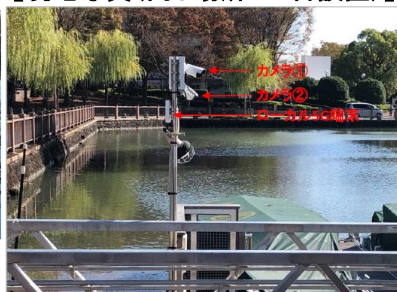
【現地写真(同じ場所に2台設置)】
