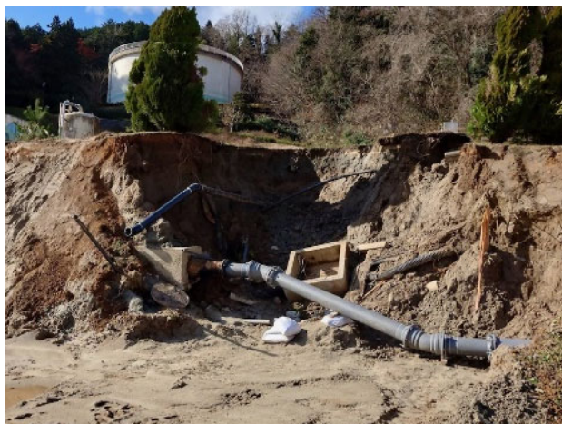
浄水場内の配管損傷（七尾市）
