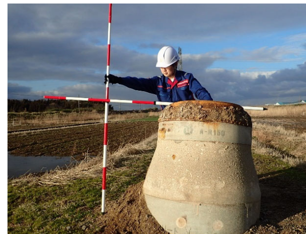
マンホール浮上現場（中能登町）
