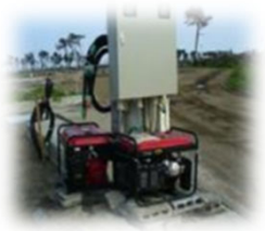
可搬型発電機
