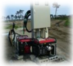
可搬型発電機
