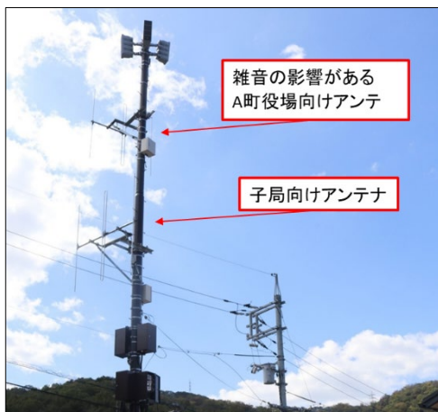
防災無線のアンテナ
