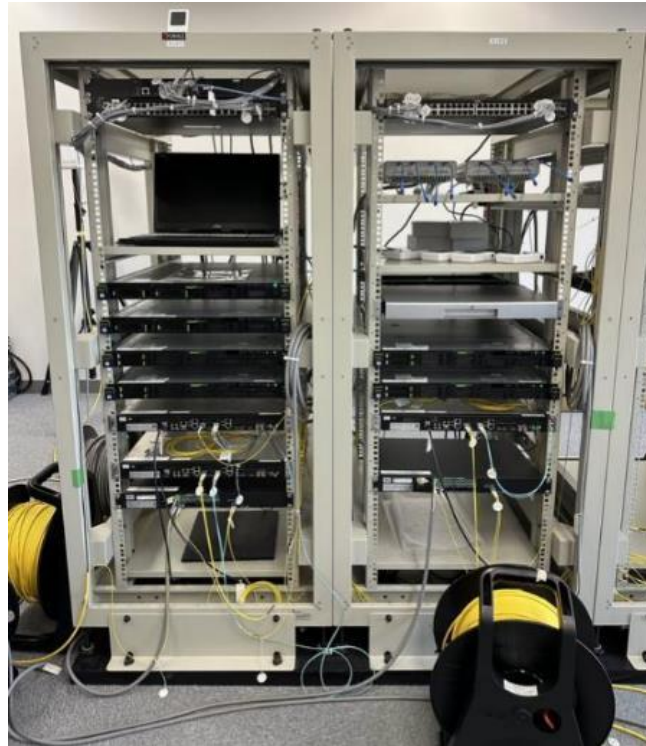
図 4-6 制御装置の設置環境
