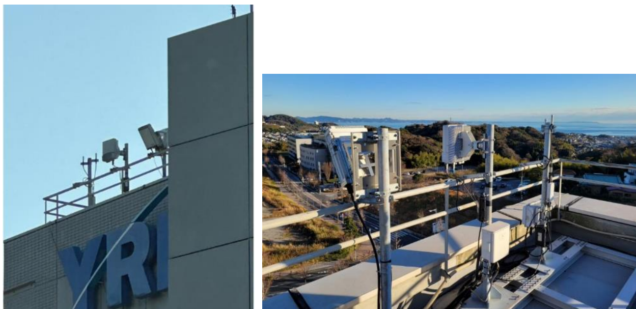
図 4-5 屋外基地局(アンテナ)の設置環境
