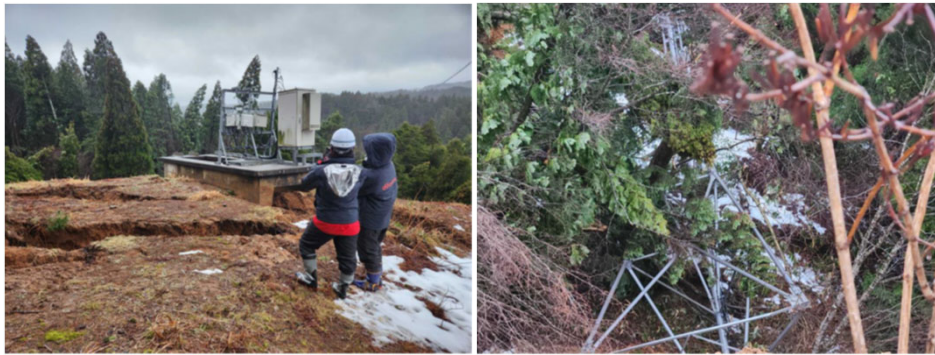
倒壊した基地局
