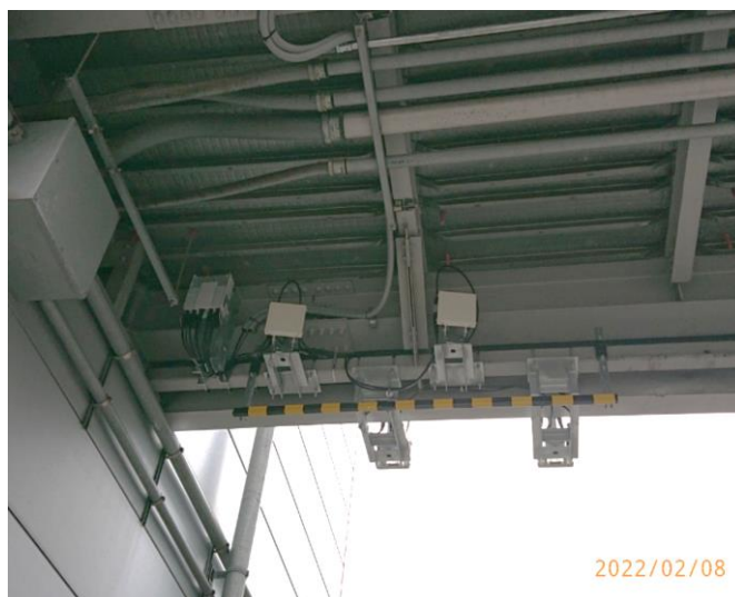
図 2-7 Site1-2 基地局設置写真
