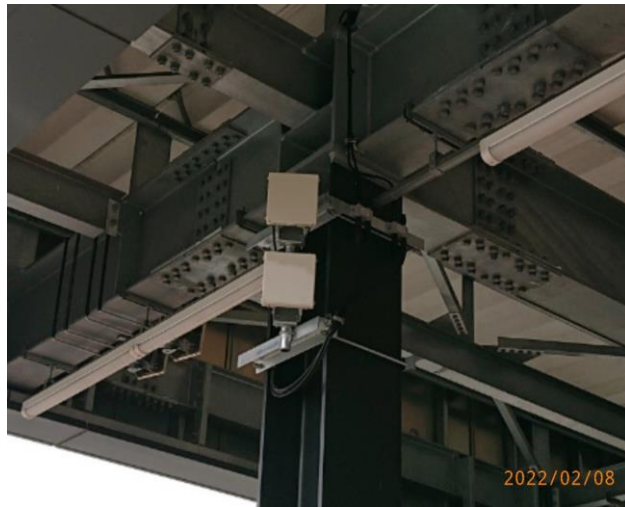
图 2-11 Site3-2 基地局設置写真
