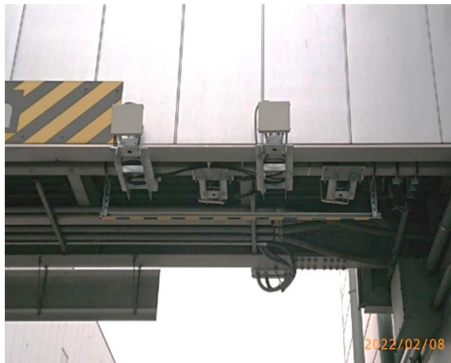
図 2-6 Site1-1 基地局設置写真
