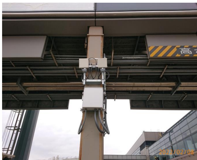
图 2-9 Site2-2 基地局設置写真
