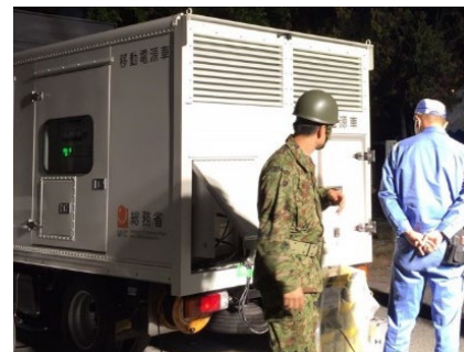
移動電源車の配備例
