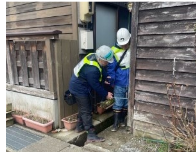
建物被害認定調査 (石川県輪島市)
