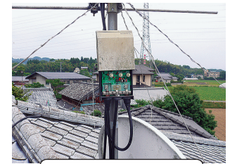
経年劣化したブースター
