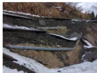
送水管の被害(輪島市)
