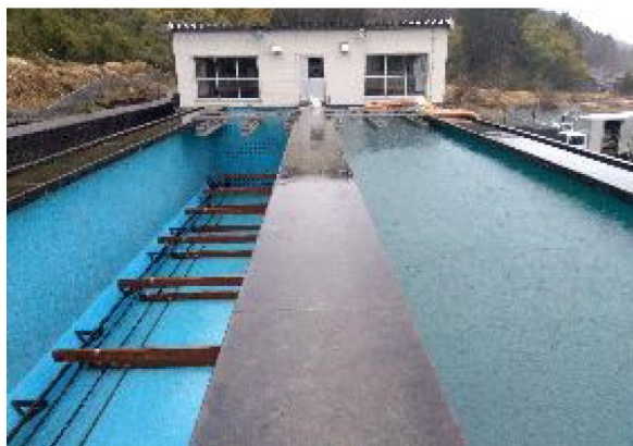
浄水場の被害（珠洲市）
