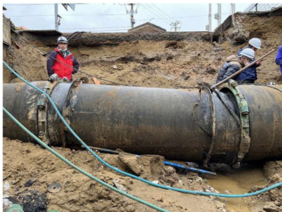
送水管の被害（七尾市）
