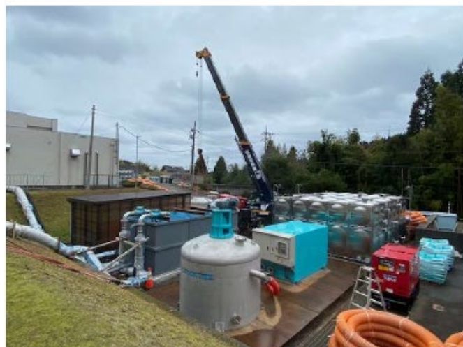
宝立浄水場可搬式浄水装置
