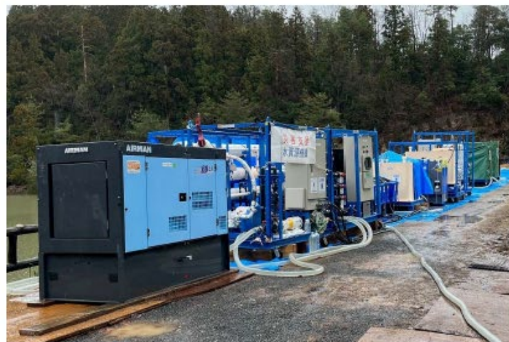
珠洲市亀ヶ谷(かめんた)池に設置した可搬式浄水装置
