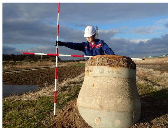
マンホール浮上現場（中能登町）
