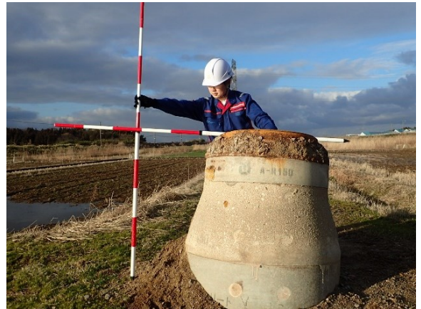
マンホール浮上（中能登町）
