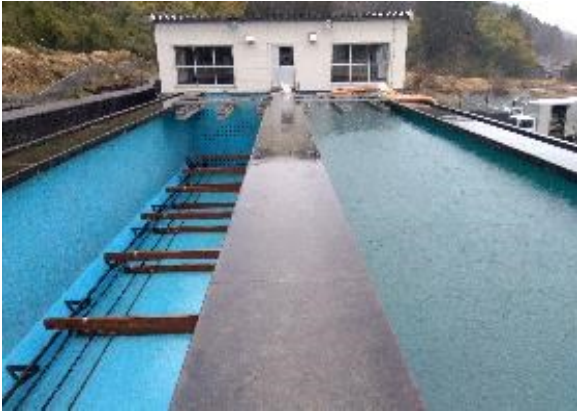
浄水場の被害（珠州市）
