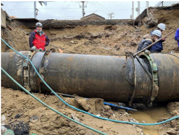
送水管の被害（七尾市）
