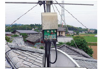
経年劣化したブースター
