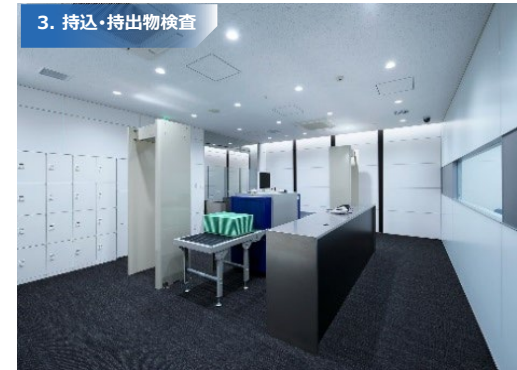
3. 持込・持出物検査
